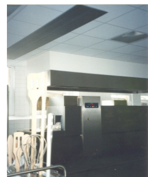
Zuluft-Quellauslaß und Wandablufthaube
