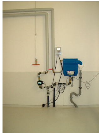
Einspeisung Waschwasser für Schlauchwäsche aus Regenwasserzisterne
