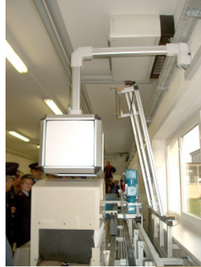
Beheizung und Schlauchtrocknung über Gebläse- konvektoren
