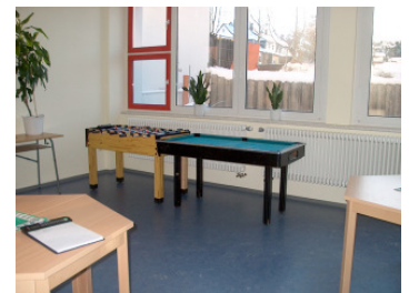
Röhrenradiatoren zur Beheizung Speisesaal
