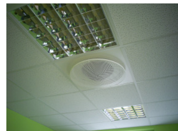
Luftauslässe für Zu- und Abluft
